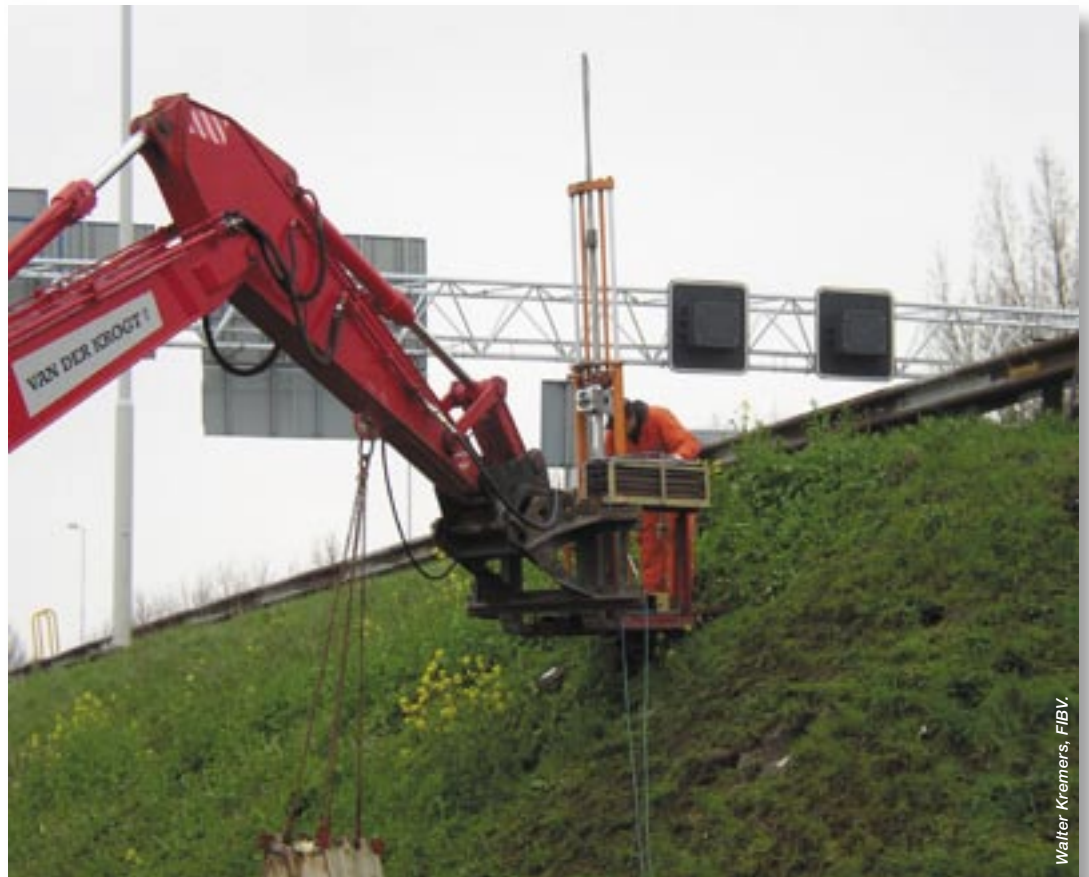
Sonderen op talud met behulp van een bandenkraan en een los sondeer-apparaat.
